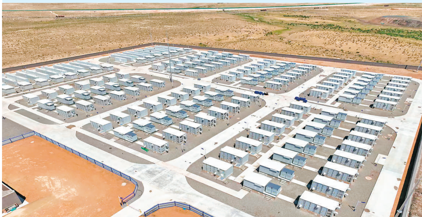
鲁家窑第一储能电站全景。
