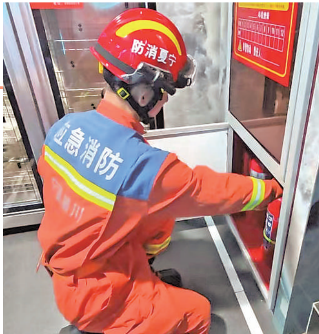
消防员检查商铺的灭火器能否正常使用。
