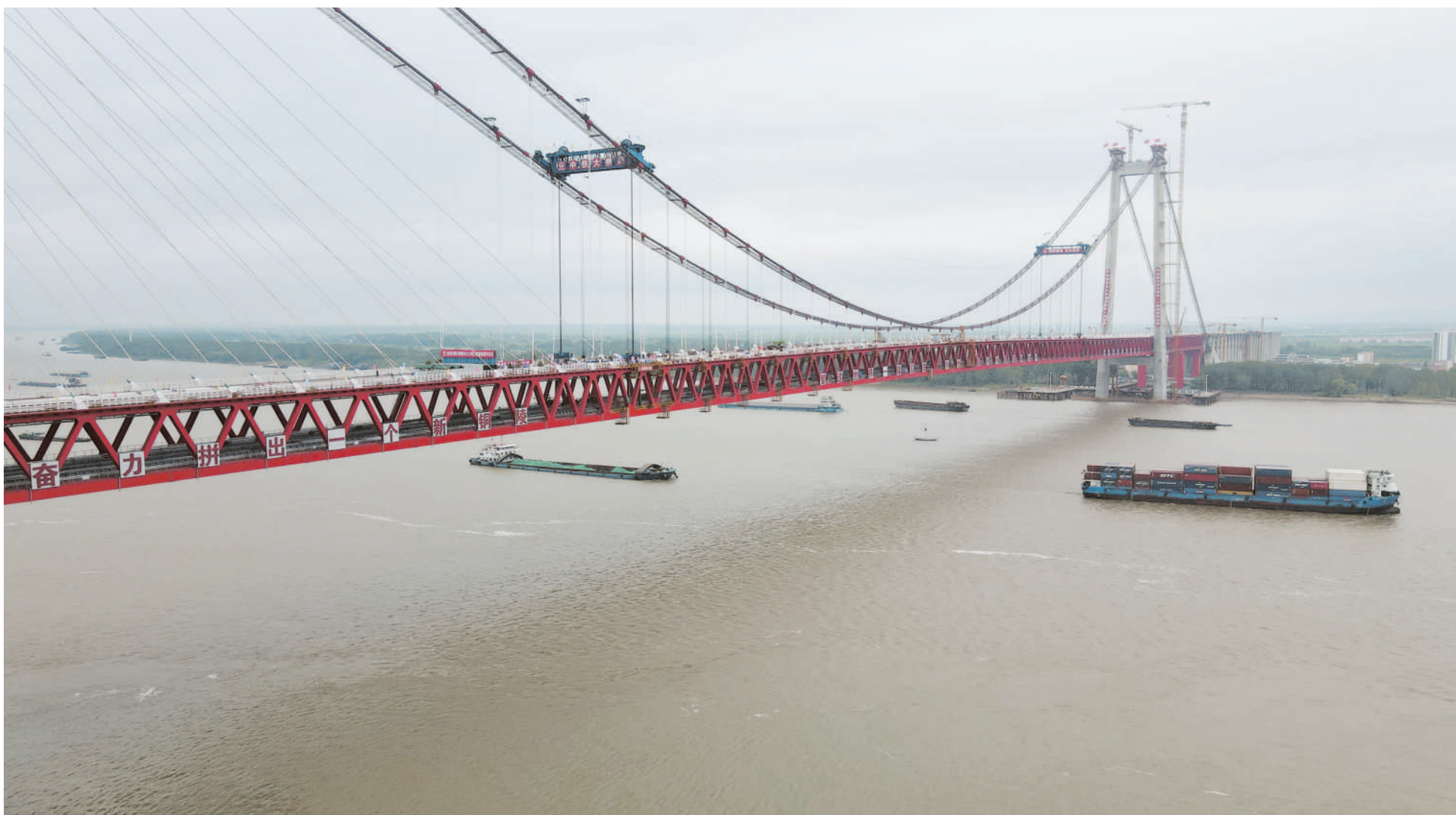
8月27日拍摄的G3(京台高速)铜陵长江公铁大桥合龙现场(无人照照片)。当日,由中铁大桥局承建的G3(京台高速)铜陵长江公铁大桥主桥合龙。该桥是一座双层斜拉——悬索协作体系大桥,全长11.88公里,主跨988米,具有高速公路、城际铁路、货运铁路三种过江功能。大桥计划于2025年建成,建成通车后对于加快区域协调发展、加强长三角互联互通具有重要意义。
