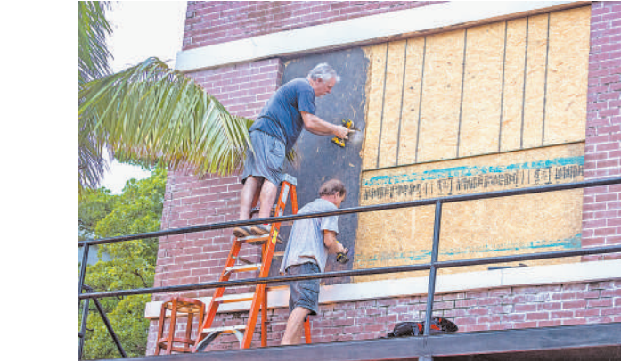
10月8日,在美国佛罗里达州迈尔斯堡,当地居民在房屋二楼窗上固定胶合板,为迎接飓风“米尔顿”做准备。飓风“米尔顿”7日骤然升级为最高级别五级,继续向美国佛罗里达州逼近,预计将成为继9月26日四级飓风“海伦妮”登陆佛罗里达州后两周来侵袭该州的第二场超强风暴。新华社/欧新
