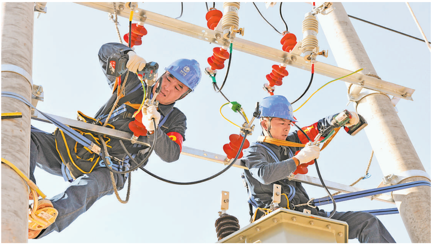
10月11日,2名选手协同进行高压避雷器引线安装。当日,2024年宁夏电力行业职业技能竞赛设置了配电网线路工和继电保护工两个工种,240名一线职工参加竞赛。
