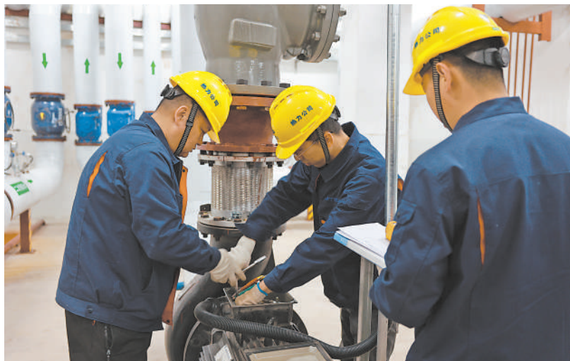
宁夏电投热力有限公司工作人员检查供暖设备。
