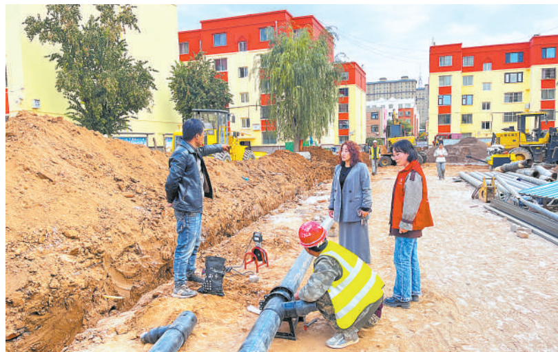
同心县豫海镇豫园社区新居南苑小区改造暖气管道。本报记者 马忠 摄
