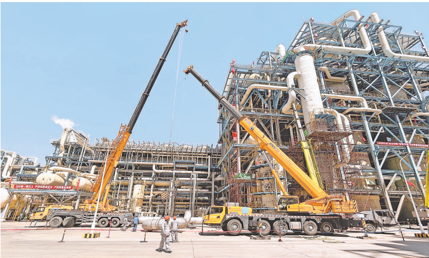
10月15日,工作人员对费托合成装置进行检修。作为目前世界上单体规模最大的煤制油项目,国家能源集团宁夏煤业公司煤制油分公司落实检修作业全视频监控要求,严格管控作业风险,加强对设备的维护和保养,做好现场标准化检修管理。 本报通讯员 崔森 摄
