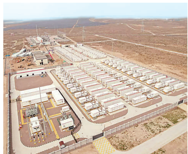
固能曙光第一储能电站全景。我区加快共享储能电站并网投运,不断提升新能源消纳能力。本报记者 鲁延宏 摄
