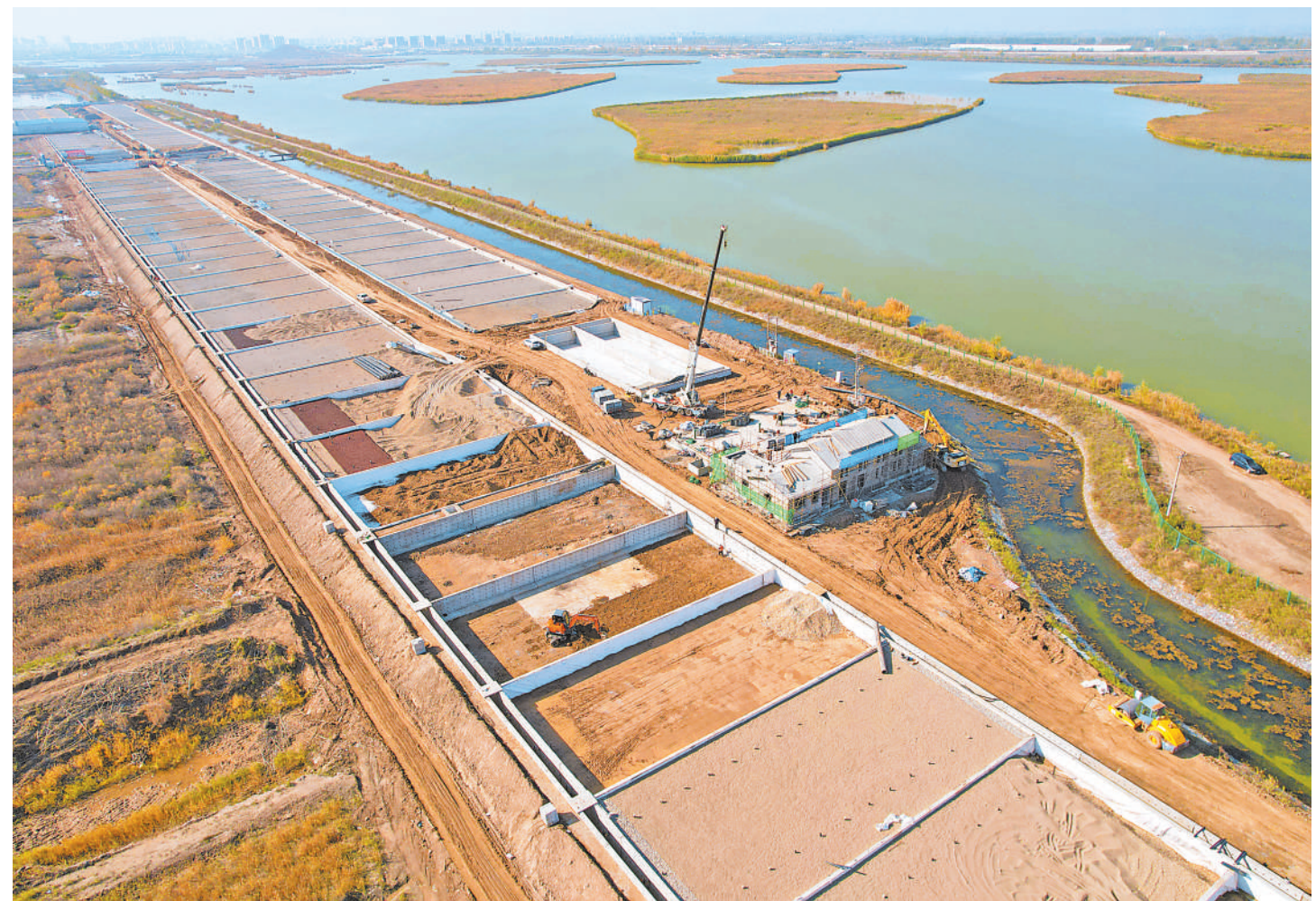
10月29日,银川市第六污水处理厂片区再生水生态利用项目在紧张施工中,预计11月上旬达到进水条件。该项目建成后,每天可处理污水2.1万立方米,处理后的污水将达到Ⅳ类标准,可用于湖泊补水、绿化用水及城市杂用。 本报记者 左鸣远 摄
