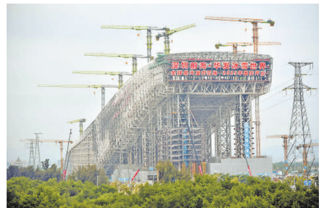
这是11月3日拍摄的深圳前海华发冰雪世界项目主体结构。由中建三局承建的深圳前海华发冰雪世界项目,目前主体结构全面封顶,已进入装饰装修阶段。该项目总建筑面积约33.93万平方米,其中雪场部分系粤港澳大湾区最大室内滑雪场,将于2025年建成对外开放。新华社发
