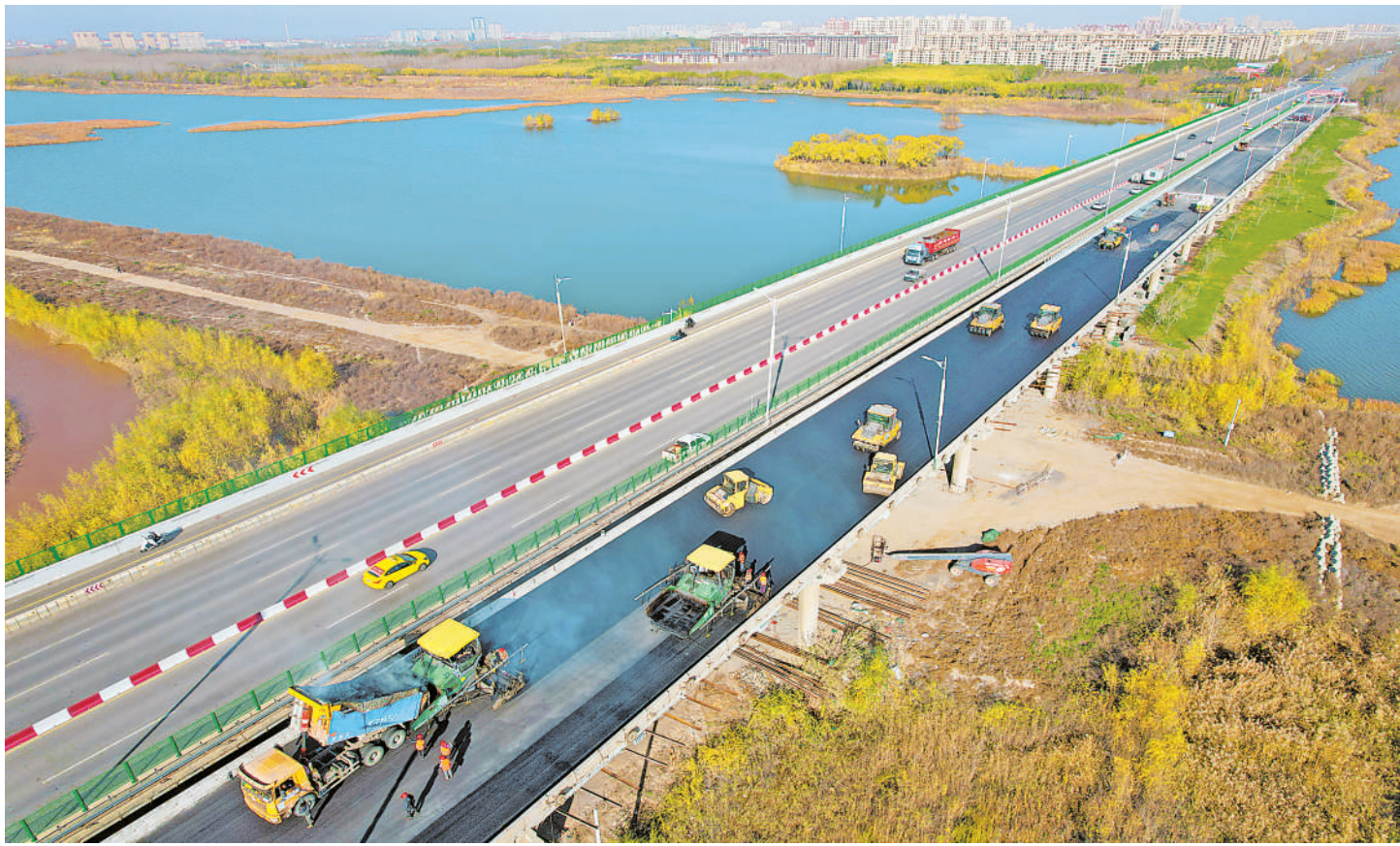
11月8日,随着最后一车沥青混合料的摊铺、碾压完成,由中国铁建大桥局承建的中卫黄河大桥旧桥加固改造工程桥面沥青摊铺施工全部完成,该项目正式进入桥面伸缩缝安装、标线施划及桥体亮化等最后的收尾工作,预计12月下旬通车。 本报记者 左鸣远 摄
