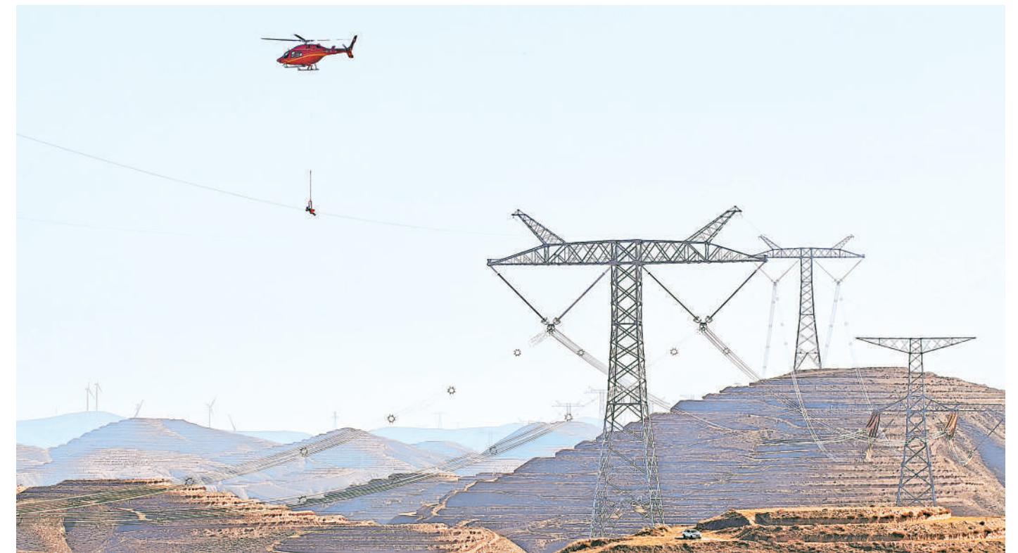
11月8日,国网宁夏电力有限公司超高压公司利用直升机绞车吊椅法顺利完成±1100千伏吉泉线地线接头补强,保障了“西电东送”大动脉安全稳定供电。 本报记者 鲁延宏 摄
