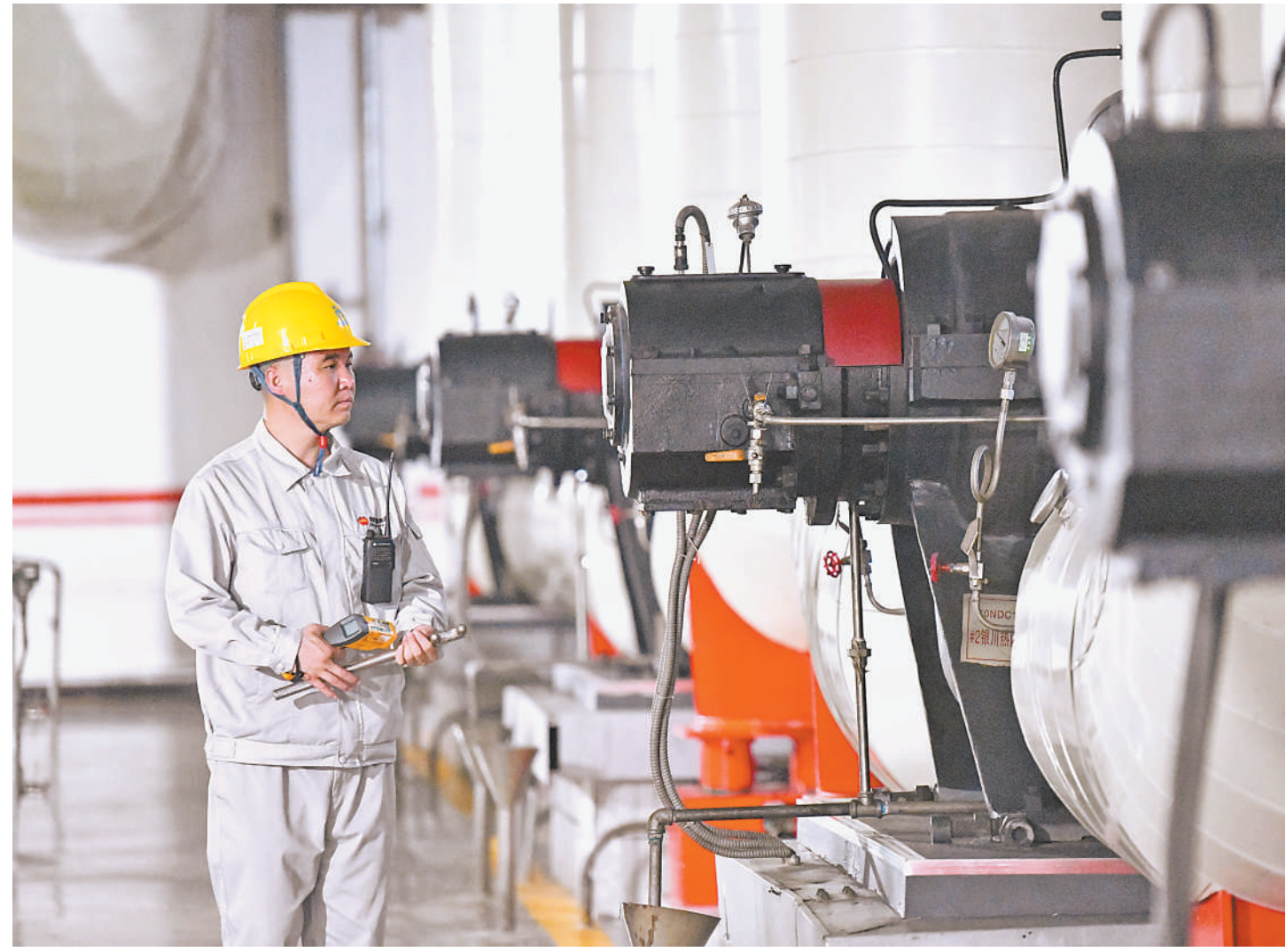
11月12日,国家能源集团宁夏电力灵武公司银川供热首站管廊交错、机声轰鸣,调度人员密切关注大屏上的各项数据变化,不时微调着供热参数,热网循环水的暖流从这里出发奔向千家万户。随着近期的降雨天气,室外温度持续下降。为了应对这一变化,国能宁夏灵武电厂已启动应急预案,全面加强供暖工作,确保居民温暖过冬。
