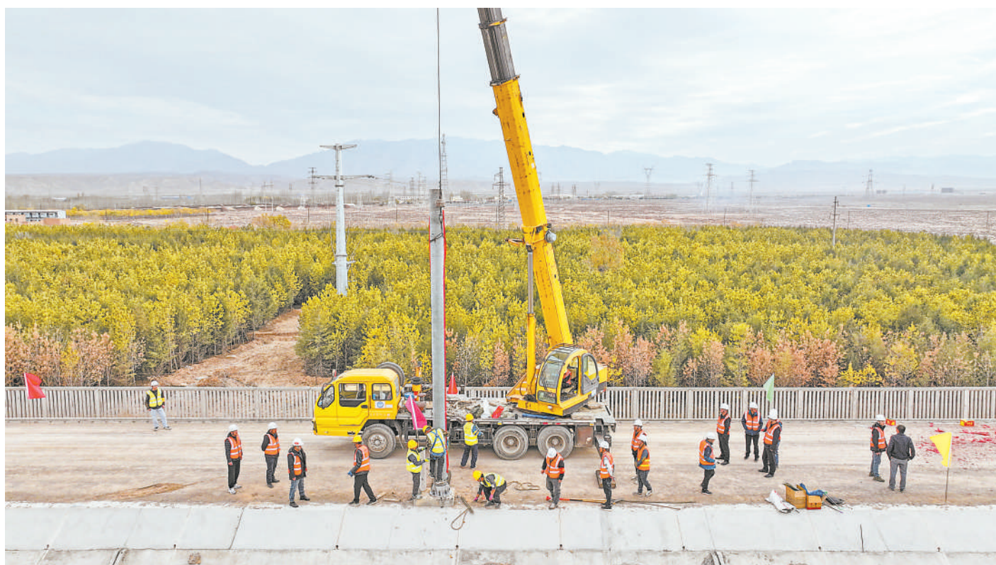
11月12日,包银高铁银巴支线内蒙古段“四电”项目接触网“第一杆”组立现场。这是该项目“四电”工程的首个重要节点。(图片由受访单位提供)
