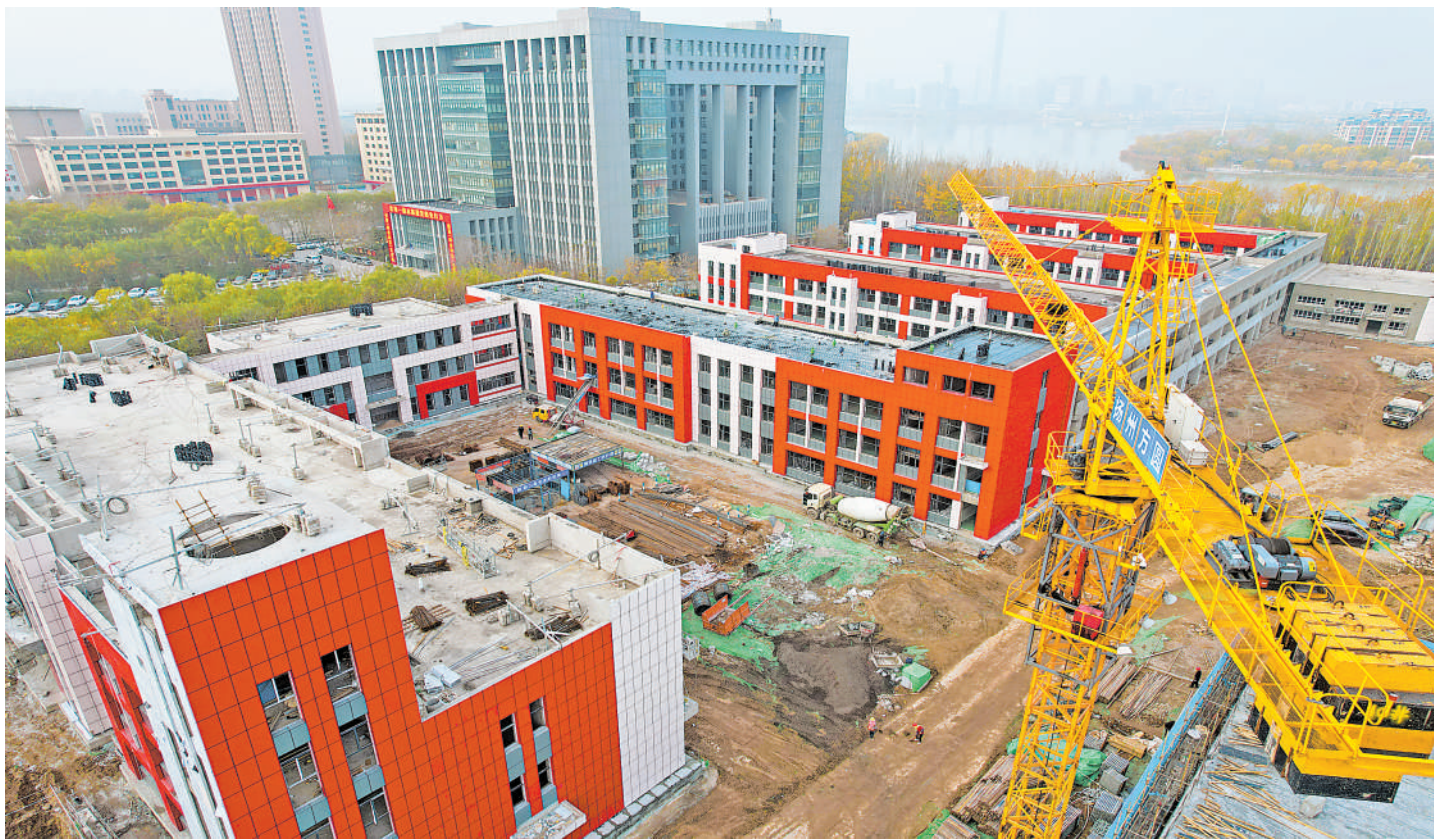
11月19日,银川市金凤区第二十五小学项目建设现场塔吊林立,翻斗车、吊车等大型机械穿梭不停,新建校舍拔地而起。该项目是金凤区今年新建的教育项目,规划设36个教学班,可提供1620个学位,预计明年7月底交付使用。本报记者 马楠 摄
