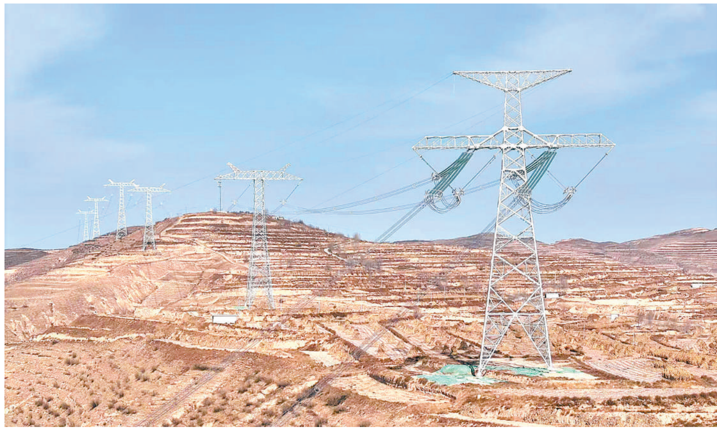
宁夏至湖南±800千伏特高压直流输电线路工程宁2标段甘宁交界处线路。
