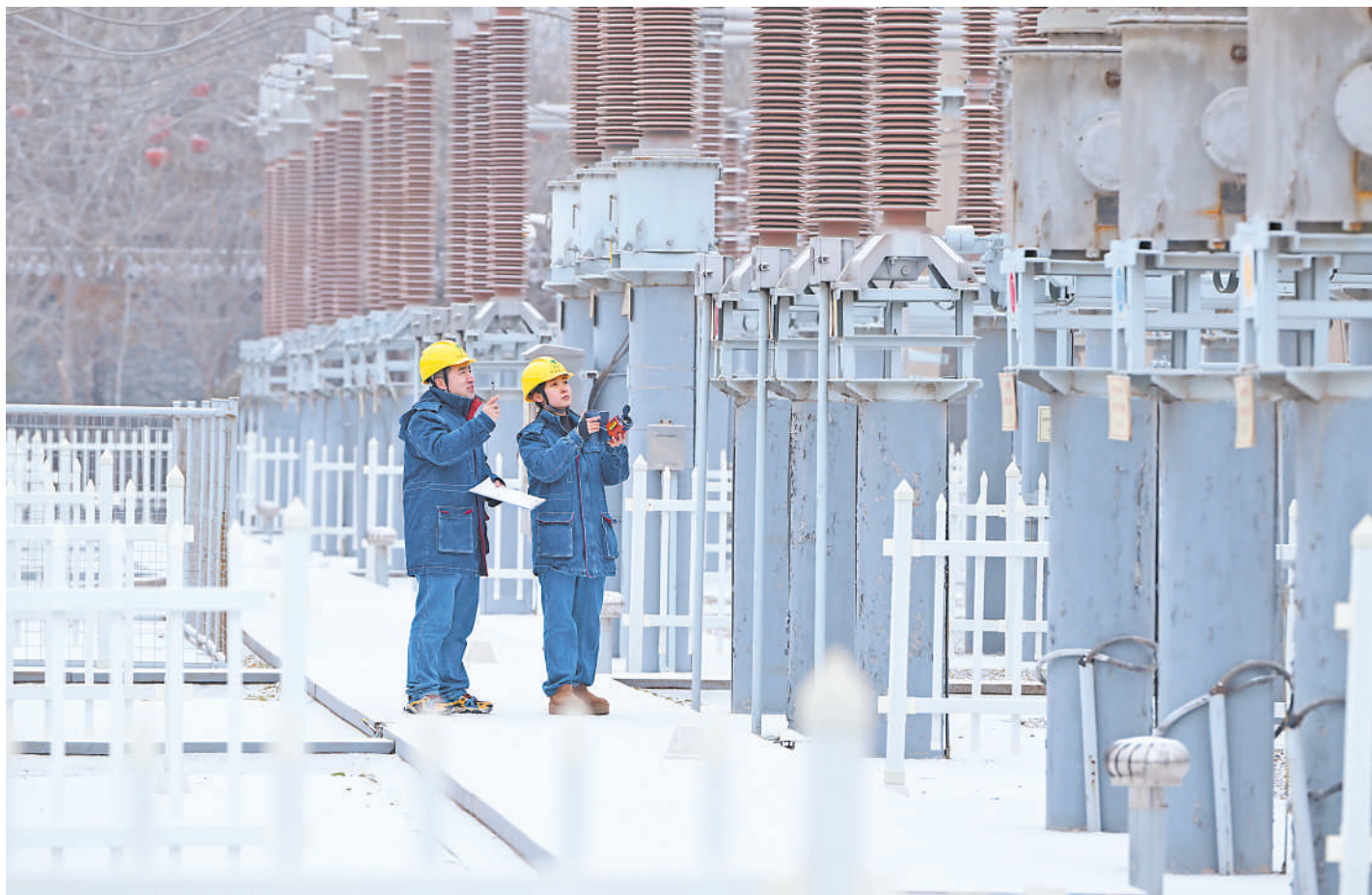
12月11日,工作人员在银川新城220千伏变电站巡视。连日来,气温下降带来用电负荷持续增长,能源保供进入迎峰度冬关键期。国网宁夏电力有限公司银川供电公司加强对枢纽变电站和重要线路巡视,保障百姓温暖过冬。 本报通讯员 袁宏彦 摄
