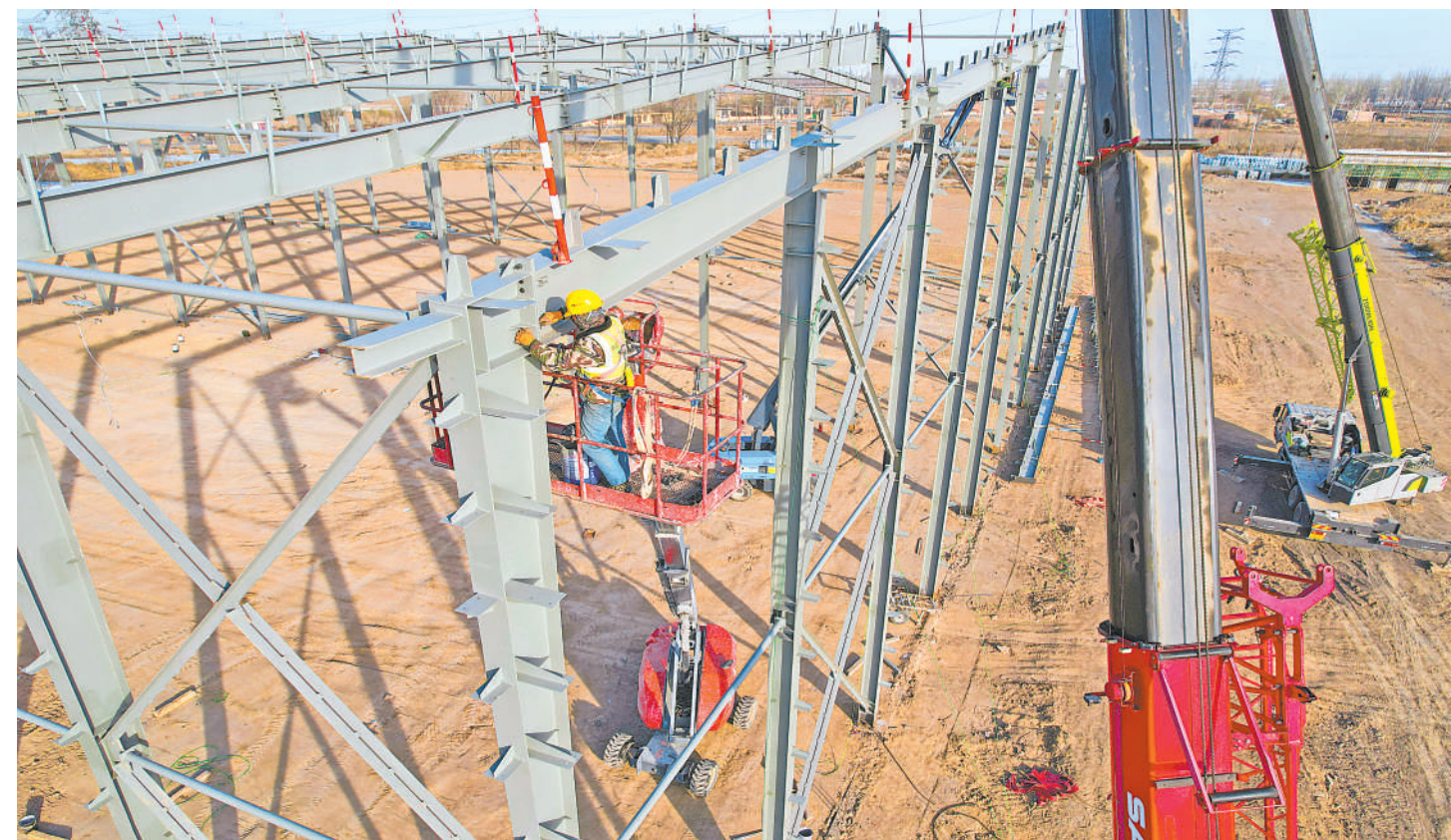
12月13日,宁夏沃滴滴水肥科技有限公司年产100万吨水肥一体化项目建设现场,大型工程机械与工人相互配合安装钢结构厂房。该项目位于贺兰工业园区暖泉片区,占地320.17亩,计划投资35.6亿元,年度投资4亿元,建设周期24个月。项目建成后,满产年销售收入可达81亿元,增加350个就业岗位。
