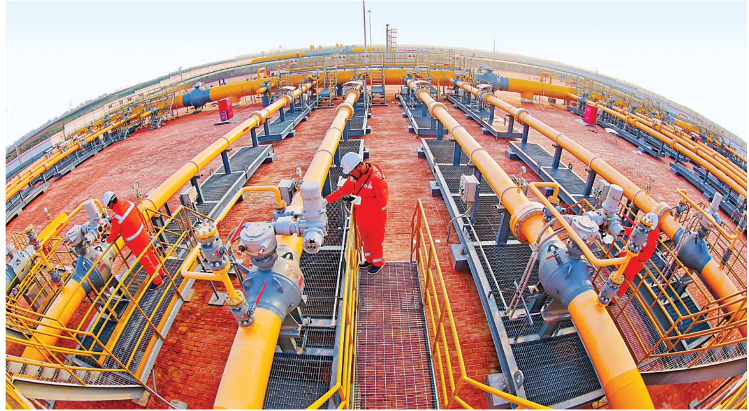
12月27日,国家管网集团西北公司工作人员在进行设备检查,服务冬季保供。
