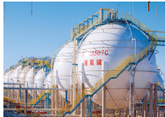
可再生氢耦合示范项目液氨罐区。
