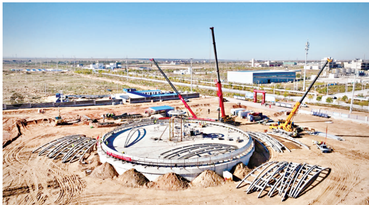
近日,盐池县宁夏氢能科技有限公司项目现场,200万立方米/天液化天然气联产60万立方米/年高纯氢气项目正在紧张建设。项目建成后,将为国内高端制造业提供优质氢气。宁夏新珂能源利用有限公司是国家级高新技术企业,液化天然气和高纯氢气是其两大“拳头产品”。2024年,该公司成立宁夏氢能科技有限公司,与三一能源装备有限公司、中海油海卓(天津)工程科技有限公司携手,计划3年分期建设4个项目。
