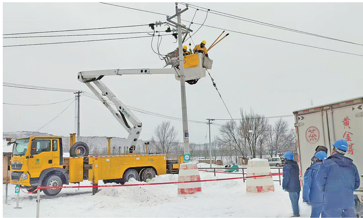
12月12日,国网原供电局工作人员开展雪天抢修作业。当日,固原市出现今冬首场大范围降雪,该公司迅速启动雨雪冰冻灾害应急响应,全力确保电网安全稳定运行。目前,固原电网整体运行平稳,电力供应充足。(图片由国网原供电公司提供)
