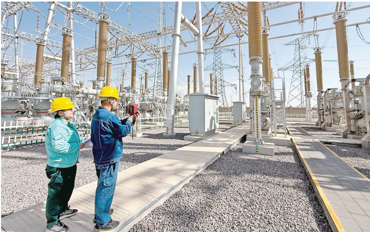
4月3日,国网宁夏超高压公司传来捷报,妙岭750千伏变电站330千伏妙虹Ⅰ、Ⅱ、妙桐Ⅰ、Ⅱ线顺利完成24小时带电试运行。此次投运的两条线路是区域能源转型的重点工程。两条“绿能动脉”的贯通,不仅织密了宁夏中南部电网的“丝路”,更打通了吴忠市红寺堡地区新能源外送“高速路”,为宁夏电网侧储能示范项目落地、吴忠直流外送稳定运行注入强劲动力。
