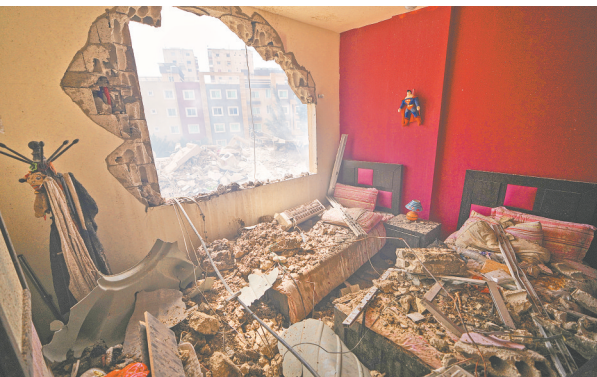
这是4月4日在黎巴嫩南部城市提尔拍摄的遭以军空袭损毁建筑内的一间卧室。以色列军方4日晚发布紧急警告,称以军即将空袭黎巴嫩与叙利亚边境黎方一侧的迈斯纳边境口岸,要求附近居民撤离。
