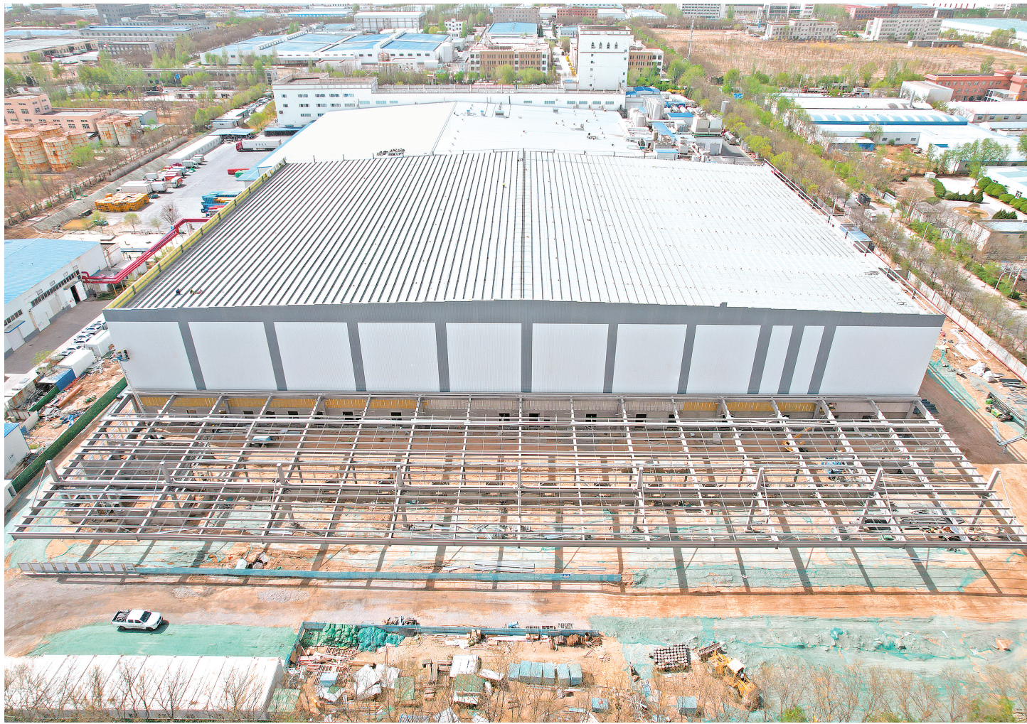
4月13日,宁夏塞尚乳业制品智能一体化应急保供中心仓项目建设现场。该项目总投资8200万元,总建筑面积超1.6万平方米,预计6月底竣工投用。项目建成后,将构建区域现代化乳制品应急保供体系,提升银川市民生必需品的储备能力,推动乳业仓储物流智能化升级。
