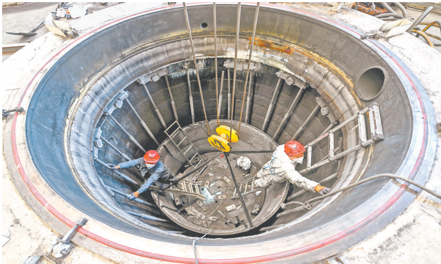
4月19日，凯本(宁夏)新材料科技有限公司年产5万件先进碳基材料产品项目，工人正在检修气相沉积炉。该公司生产的碳碳复合材料热场模具与结构件等产品能够满足国家战略性新兴产业需求，目前已有2000万元订单陆续交付中，预计今年产值超过3000万元。本报记者 王晓龙 白茹 摄
