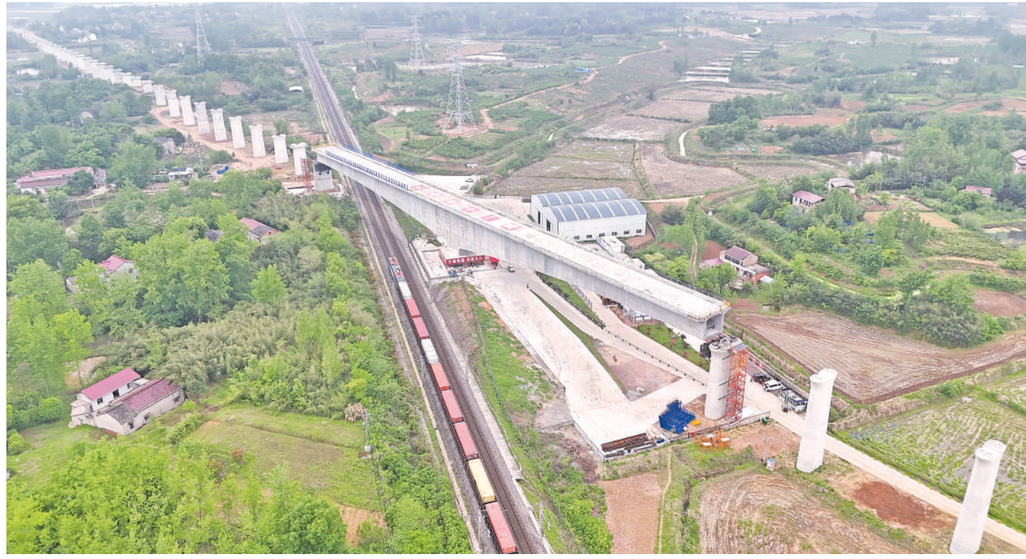
4月21日,在已完成转体的合武高铁跨西铁路万吨连续梁下方,列车在西西铁路上行线(无人机照片)。合肥至武汉高速铁路是我国“八纵八横”高铁网沿江通道的重要组成部分,设计时速350公里。线路建成后,将在合肥至武汉间形成新的高铁大通道,进一步优化长江经济带路网布局。
