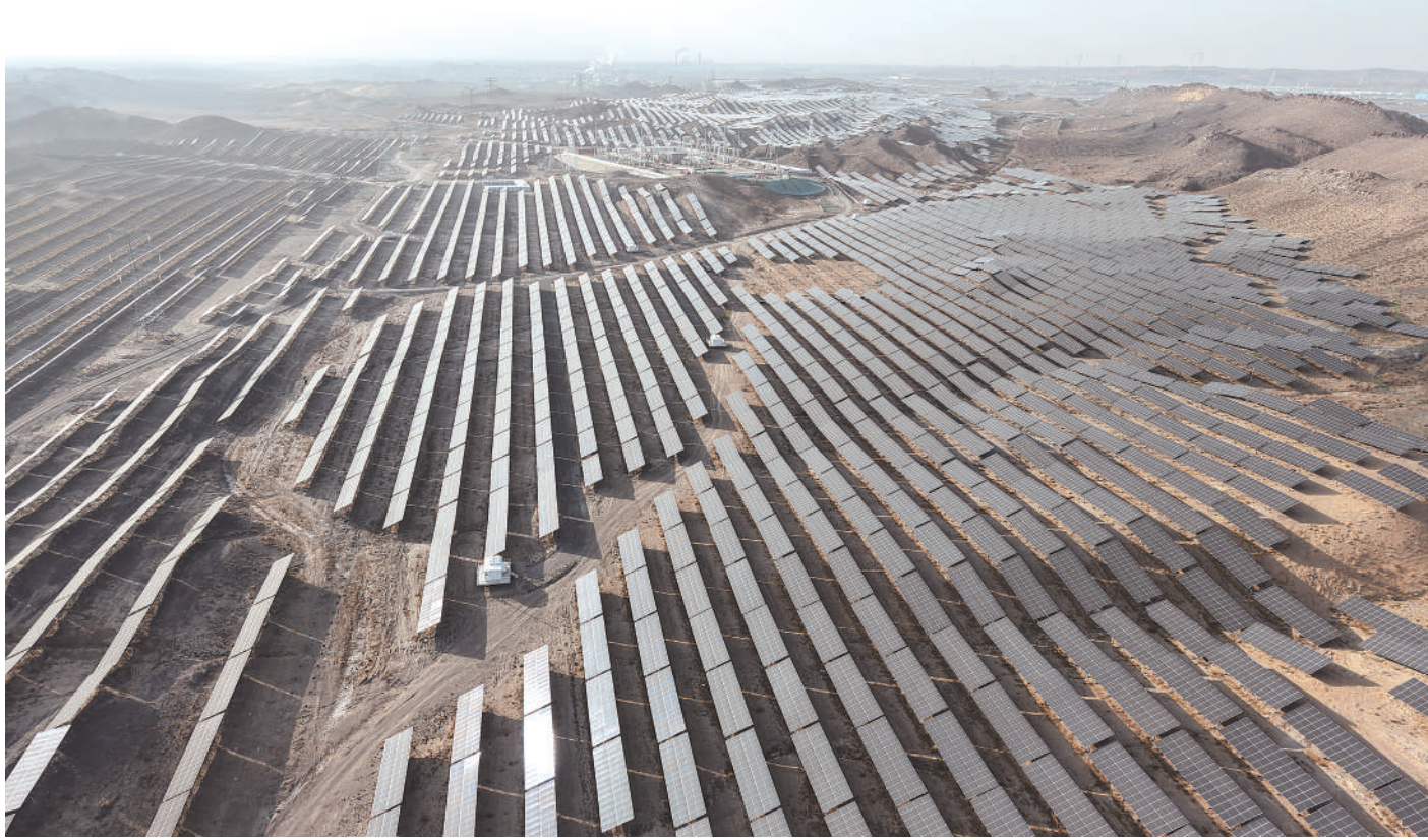
中国大唐中卫云基地50万千瓦源网荷储一体化光伏项目。
