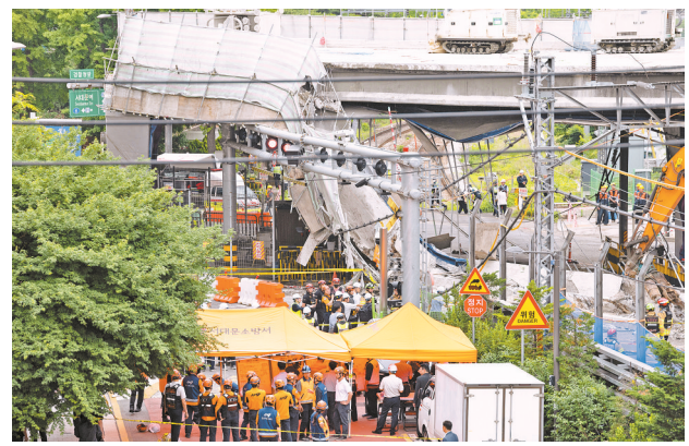
这是5月26日在韩国首尔拍摄的高架桥坍塌的事故现场。韩国首都首尔一座高架桥的拆除现场26日下午发生坍塌事故,目前已造成3人死亡、至少3人受伤。新华社发
