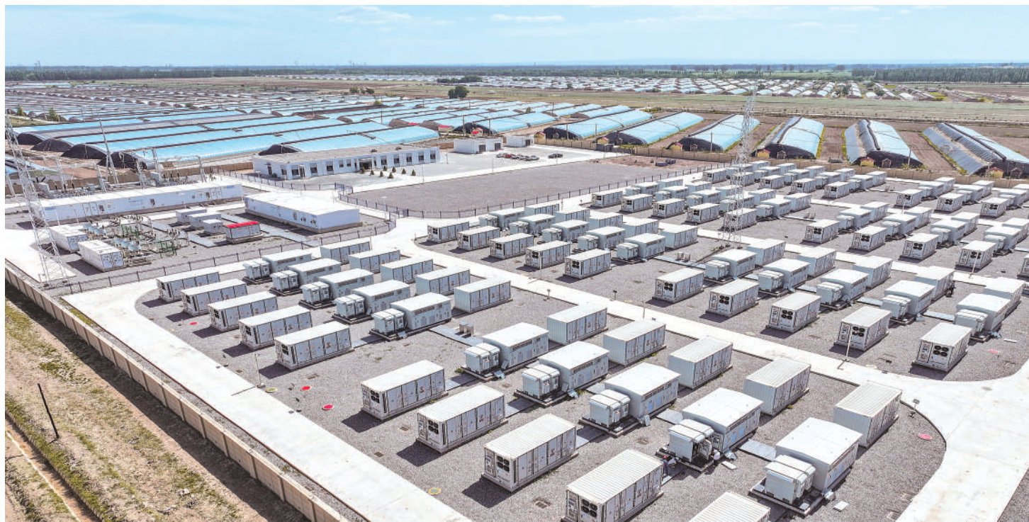
位于银川市永宁县李俊镇的宁夏誉诚昊达新能源200MW/400MWh共享储能电站(5月30日摄)。该项目于近期倒送电一次成功,年充放电可达300次,预计年产值约5000万元,可有效提升区域消纳能力,增强电网稳定性。 本报记者 马楠 李宏亮 摄
