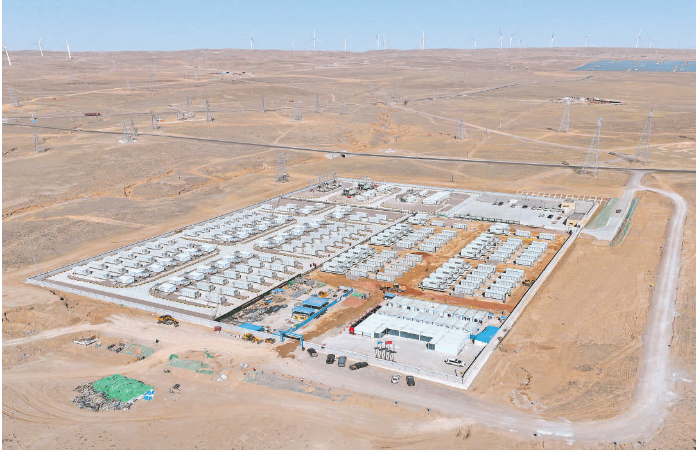
俯瞰宁夏青龙山200兆瓦/400兆瓦时新能源共享储能电站示范项目。
