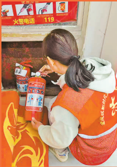
银川市金凤区满城北街街道满春园社区网格员查看居民楼道里配备的灭火器。
