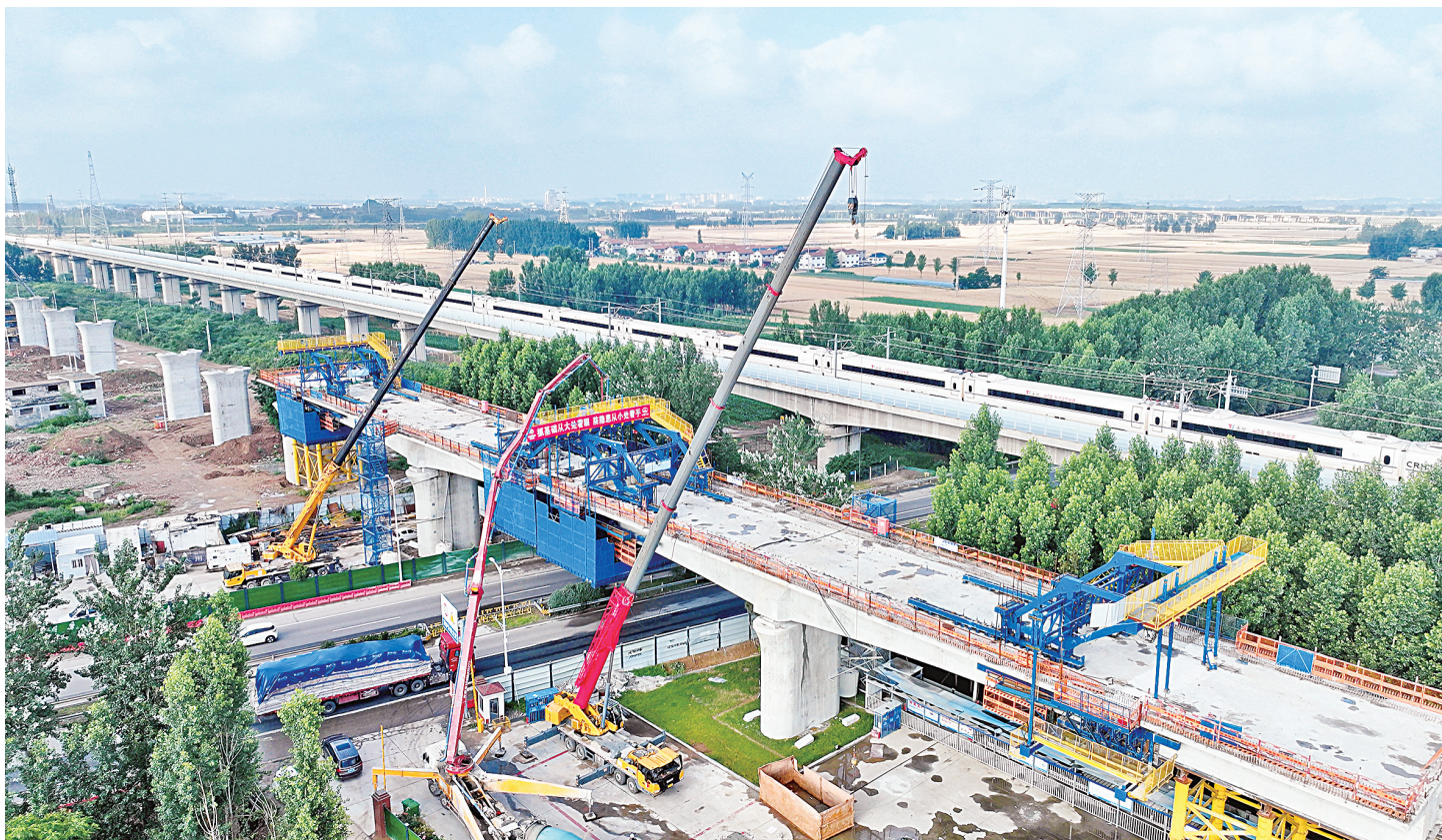
6月4日,在济枣高铁山东曲阜段,中铁五局的工作人员在进行跨G327国道连续梁合龙作业(无人机照片)。当天,由山东铁投集团投资、中铁五局承建的济(南)枣(州)高铁山东曲阜段跨G327国道连续梁顺利合龙,为后续架梁施工打通了关键通道。
