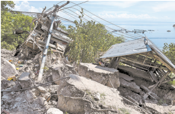
这是6月10日在菲律宾南部萨兰加尼省格兰镇卡帕坦村拍摄的地震损毁房屋。据菲律宾国家减灾委员会6月10日通报,菲南部棉兰老岛附近海域8日发生的7.8级强震已造成至少45人死亡,487人受伤,17人失踪。通报说,此次地震造成超过3.3万户家庭,共计近15万人受到影响,已有超4.1万名受灾群众被迫转移安置。包括医院、学校、桥梁在内的238个设施遭到损毁,还有近3000个房屋遭到破坏。新华社/路透
