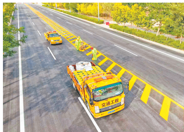
6月17日,工人在C303惠安延伸段施划双组分标线。该路段地处石嘴山市惠农区尾闸镇城郊结合部,原沥青路面已服役14年,存在裂缝、坑槽、积水等病害。据了解,惠农区于3月15日启动2026年农村公路新建、改扩建、路况提升等项目,将改善红果子镇、尾闸镇、礼和乡、燕子墩乡、简泉农场等地共计41公里农村道路。目前已完成17.5公里,计划10月底全部完工。
