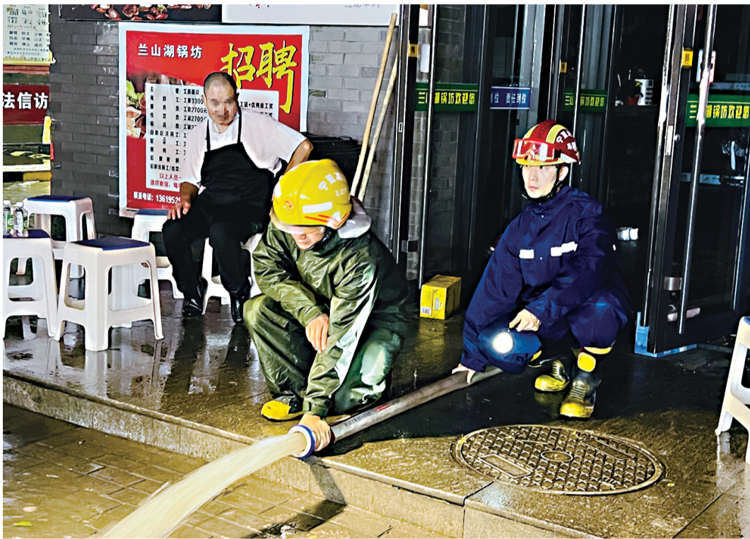
消防救援人员帮商户排除积水。 消防部门供图
