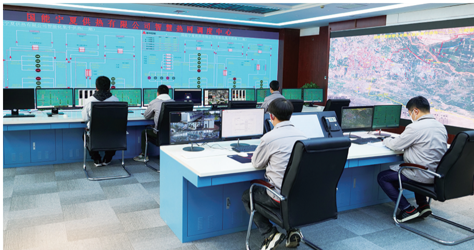
国能宁夏供热有限公司工作人员监控供热设备。
