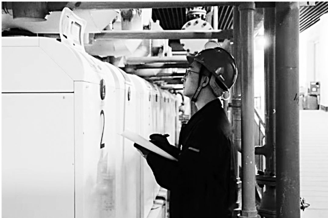
济南的新能源供暖设备。 网络图片
