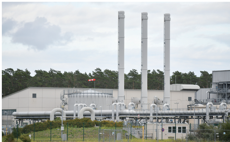
2022年9月14日在德国卢布明拍摄的“北溪-1”天然气管道相关设施。 新华社发
